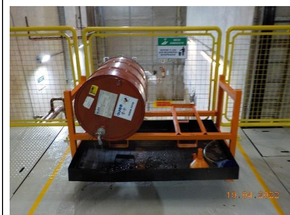
Foto 13. Bacia de contenção móvel.
