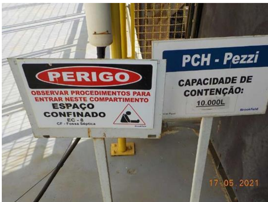
Foto 3-1. Fossa Séptica – PCH Pezzi.
