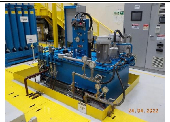
Foto 10. Bacia de contenção em equipamentos hidráulicos.
