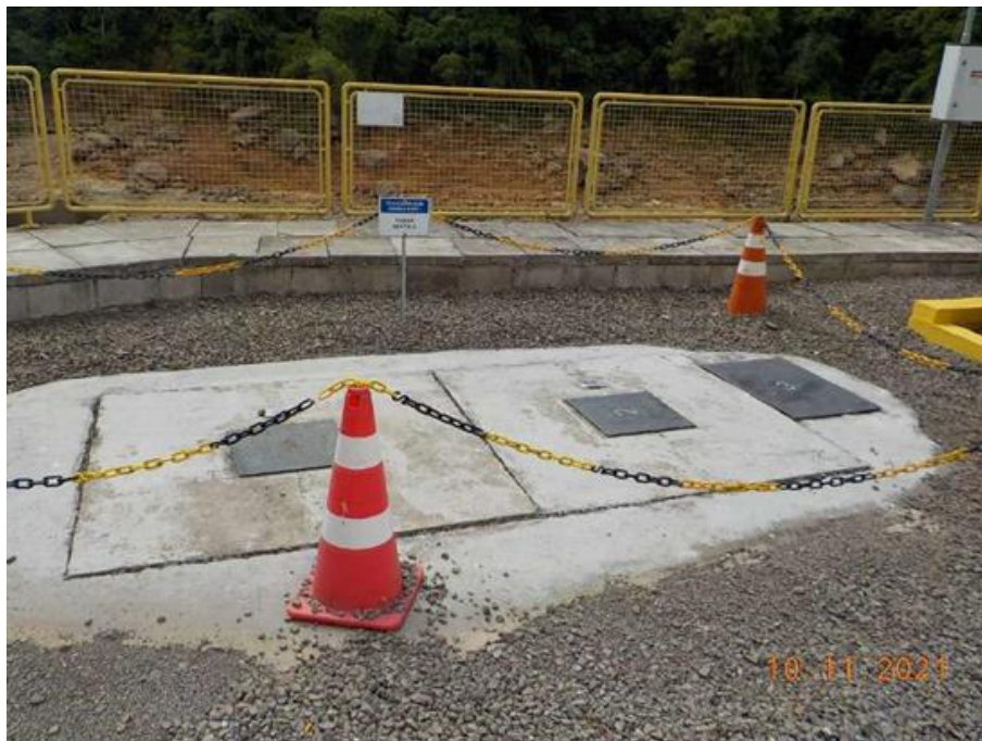
Foto 3-3. Sistema de tratamento de efluente - PCH Serra dos Cavalinhos I.
