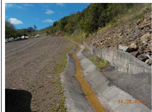
Foto 5. Canaletas de drenagem na PCH Serra dos Cavalinhos I
