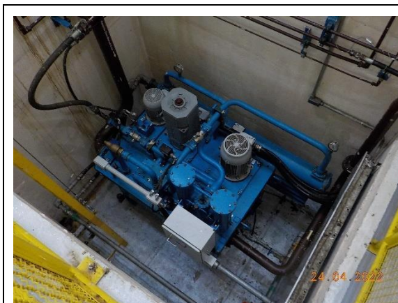
Foto 11. Bacia de contenção em produtos químicos de uso específico.
