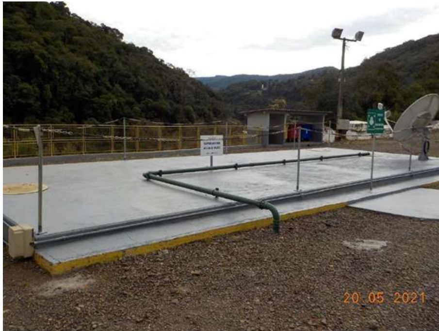
Foto 3-7. Sistema separador de água e óleo - PCH Passo do Meio.
