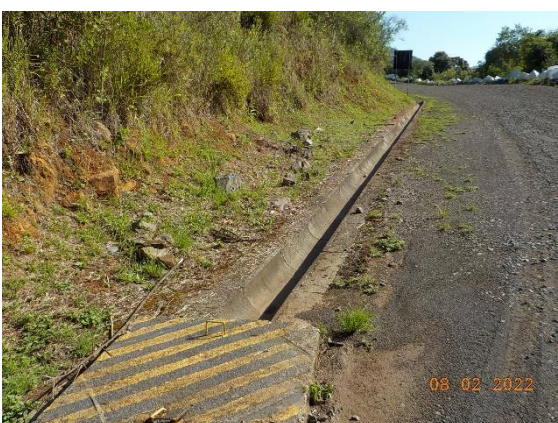
Foto 6. Canaletas de drenagem e caixa de passagem na PCH Serra dos Cavalinhos II.
