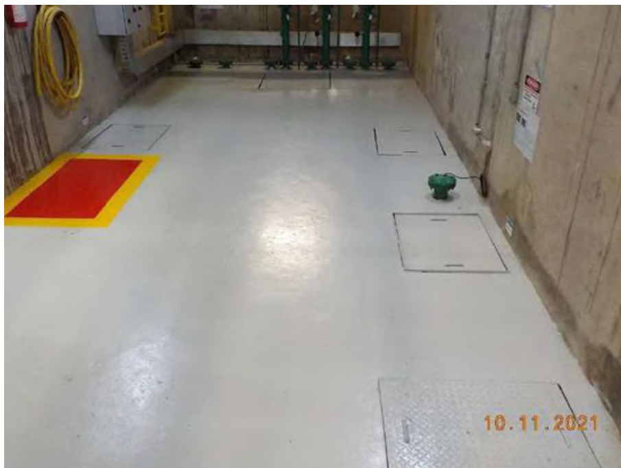
Foto 3-8. Caixa separadora de água e óleo da casa de força - PCH Serra dos Cavalinhos I.
