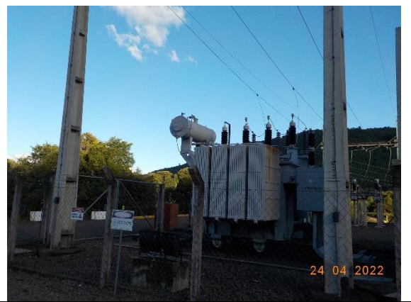
Foto 4. Subestação – PCH Serra dos Cavalinhos II.
