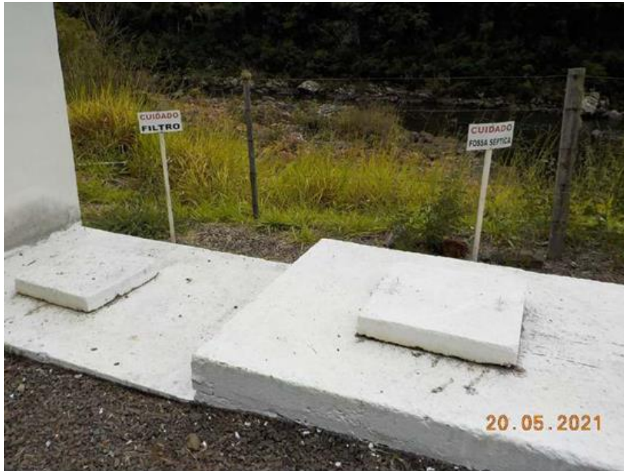
Foto 3-2. Sistema de tratamento de efluentes - PCH Passo do Meio.
