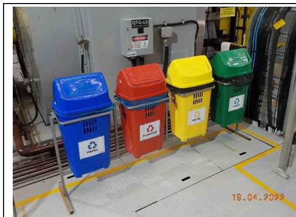
Foto 19. Bateria de lixeiras – área interna.
