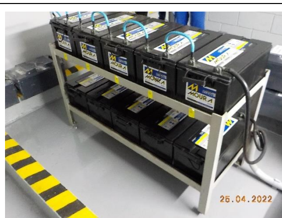
Foto 12. Banco de baterias protegido por bacia de contenção fixa.
