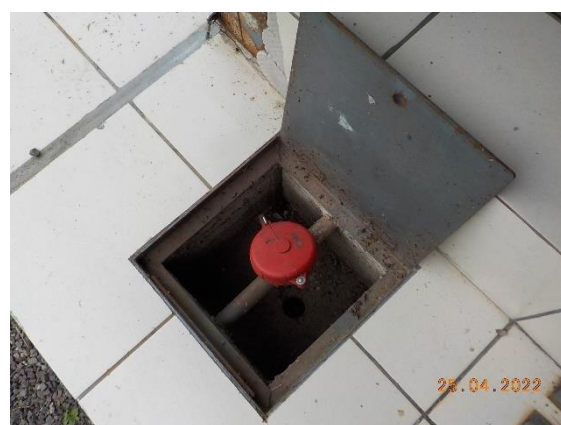
Foto 14. Válvulas de esgotamento devidamente fechadas e lacradas.
