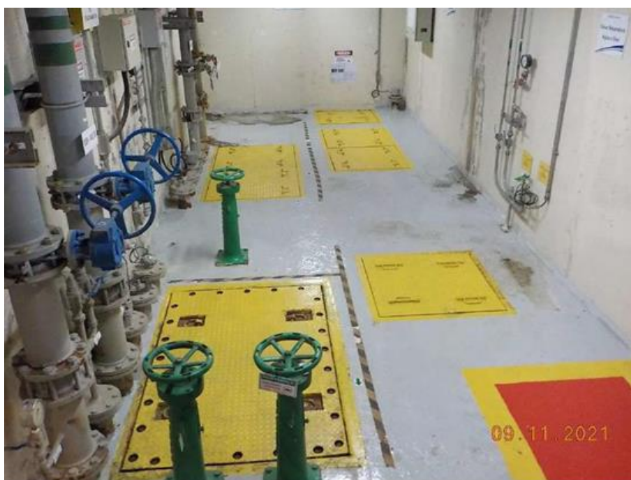
Foto 3-10. Caixa separadora de água e óleo da casa de força - PCH Serra dos Cavalinhos II.
