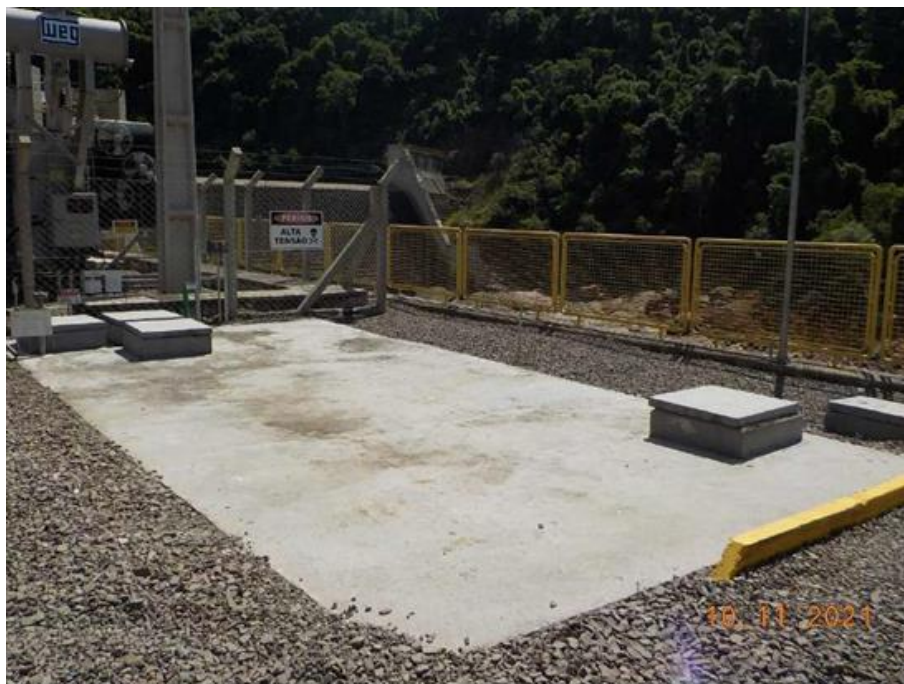
Foto 3-9. Sistema Separador de água e óleo subestação – PCH Serra dos Cavalinhos I.
