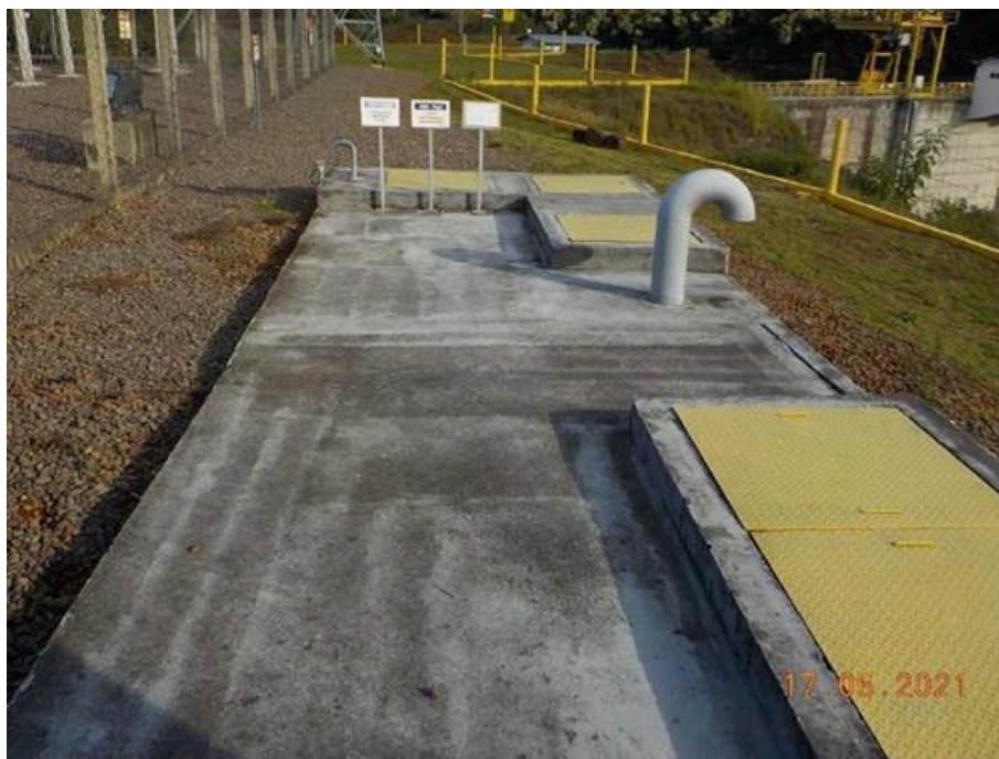
Foto 3-6. Sistema Separador de água e óleo subestação – PCH Pezzi.
